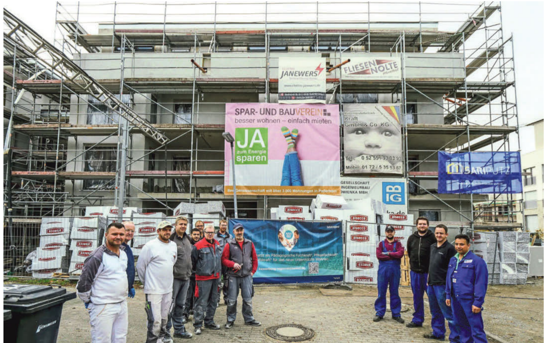
Zahlreiche Gewerke arbeiten an der Wittekindstraße an der Fertigstellung des Neubaus für das gemeinsame Wohn- und Unterstützungsangebot von Spar- und Bauverein Paderborn und dem Stiftungsbereich Bethel.regional. Foto: Ralph Meyer
